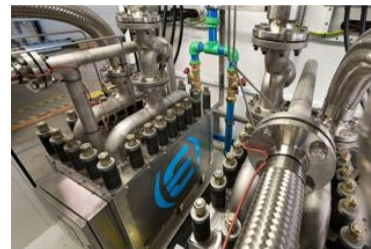
水素製造装置
