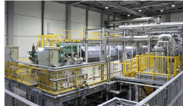
旭化成の10MW水電解装置
